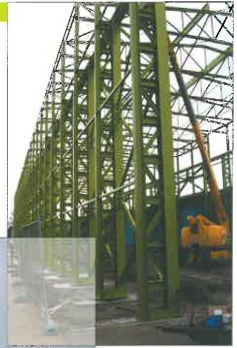
Montage staalconstructie productiehal Installation of steelbuilding for a factory Montage de construction en acier pour une fabrique Montage Stahlbau Fabrikgebäude
